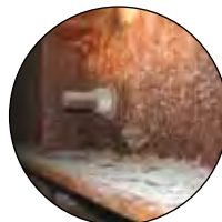
Óxido y corrosión
